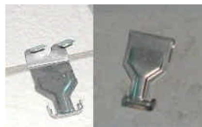
写真4 クリップの損傷状況
