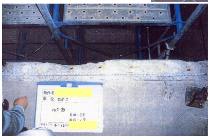
コンクリート製手摺りが落下した10階部分の痕跡
