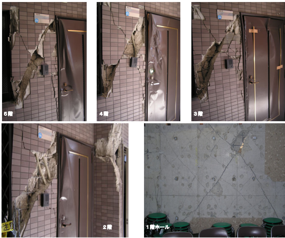
2005年福岡沖地震で被災した14階建の新築マンション(2)
