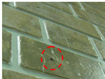
(c) -S-試験体 1/30rad. 時 釘の引き抜け
