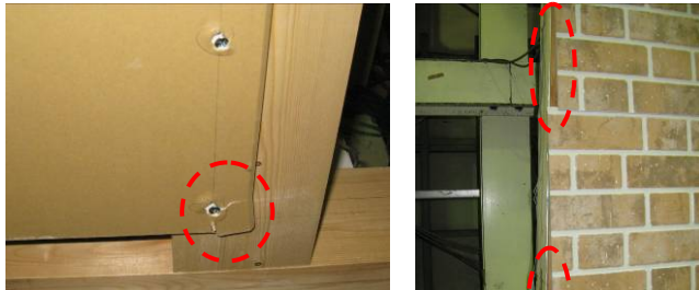
(a) GGG 試験体 1/60rad. 時 四隅の剥離
