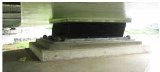
写真2: 積層ゴム支承の設置例
