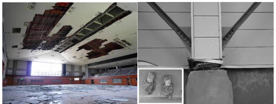
写真2 柱脚部の破壊
