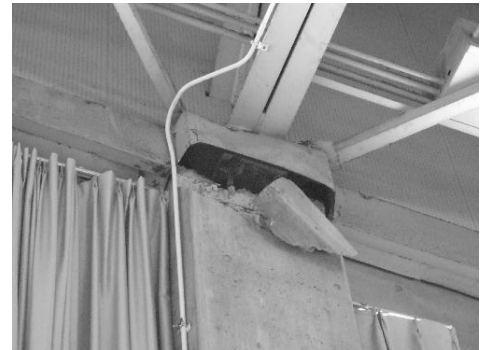
写真1 定着部の破壊
