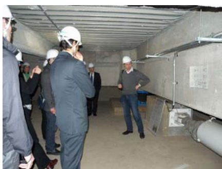
J2 棟の免震層
