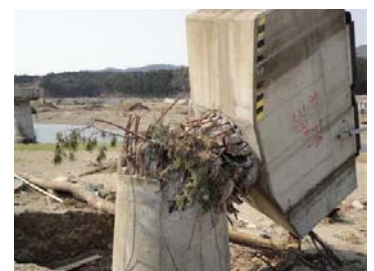
写真 9 津谷川橋梁（JR 気仙沼線） 橋脚の破壊
