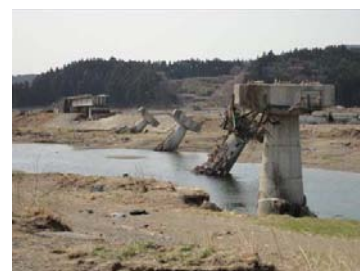
写真 8 津谷川橋梁（JR 気仙沼線） 河川内での橋脚の倒壊
