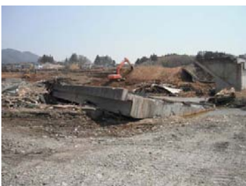
写真 4 沼田跨線橋 落下した主桁の状況
