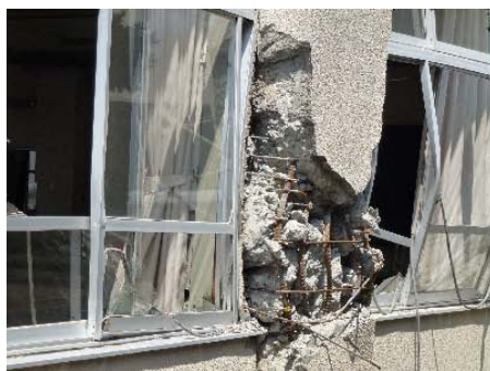
写真4 RC校舎の被害
