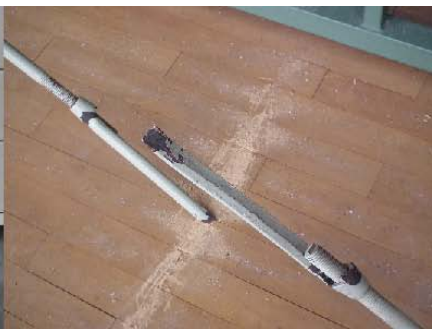
写真2 体育館筋交いの被害
