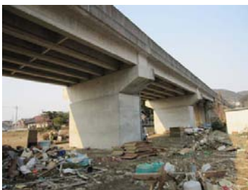
写真 1 鹿折高架橋（気仙沼市） 橋脚は完全に浸水している
