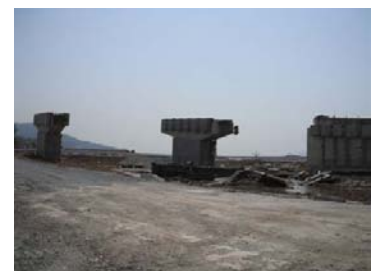
写真 3 沼田跨線橋（陸前高田市） 3 連の主桁がすべて落橋
