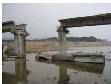
写真 7 外尾川橋梁（JR 気仙沼線） RC 主桁の落下状況
