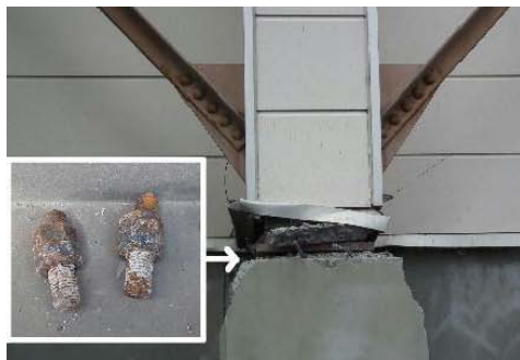
写真1 体育館柱脚の被害
