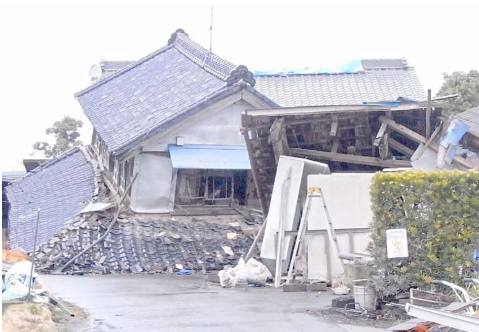
「地震で倒壊した木造住宅」
