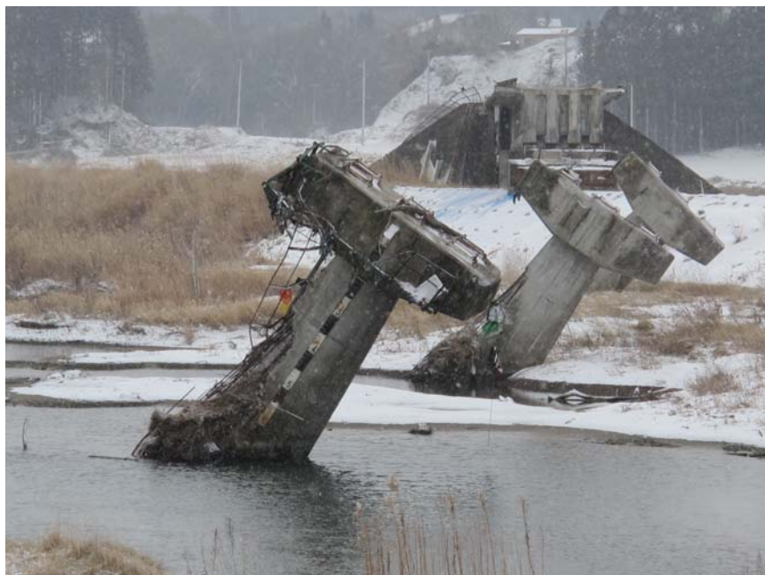
東日本大震災で被災した主桁が流出し橋脚が倒壊したJR気仙沼線の津谷川橋梁
