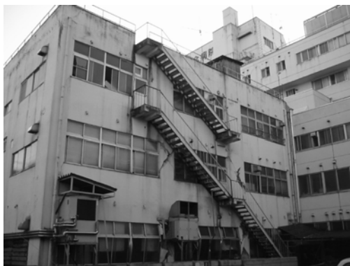
図 4 : 小千谷総合病院の被害
