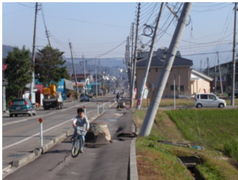
図 24: 小千谷市内における液状化によるマンホールの浮き上がり
