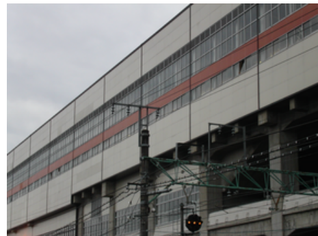
上越新幹線浦佐駅。窓ガラスが損傷か？
