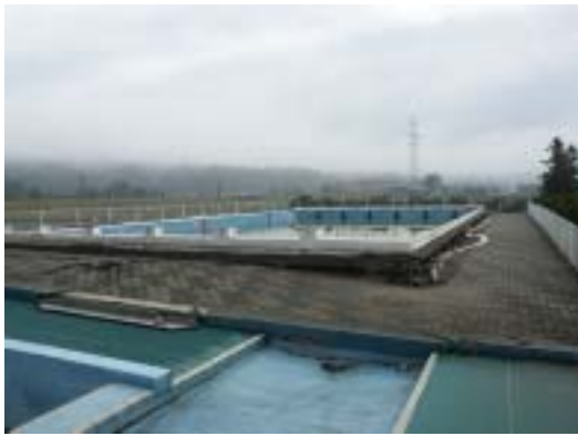
写真-9 宇賀地小学校 プール地盤変状
