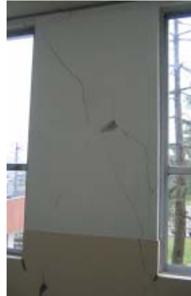
写真-3 大和中学校校舎北構面2階部分柱のせん断ひび割れ
