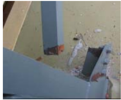
写真-12 堀之内高校 大体育館鉄骨筋違端部破断
