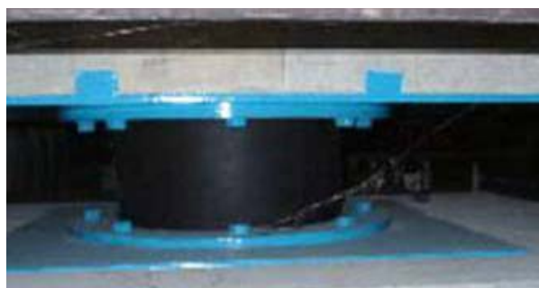
写真-21 同建物の免震装置 （新潟大学 加藤大介教授撮影）
