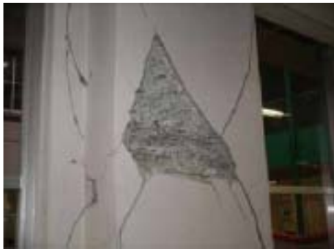
写真-5 国際情報高校 校舎柱のせん断ひび割れ (東京大学 中埜良昭助教授撮影)
