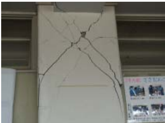
写真-6 小出中学校校舎棟2階家庭科(調理)室廊下側柱(極短柱)のせん断ひび割れ
