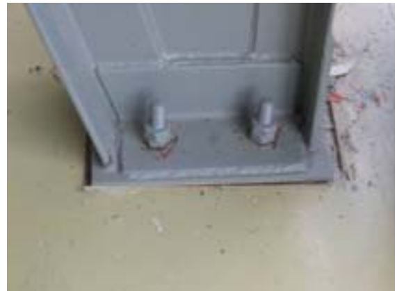
写真-13 堀之内高校 大体育館鉄骨柱脚ベースプレートずれ
