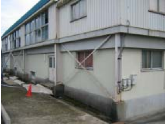
写真-1 大巻小学校体育館（筋違座屈）
