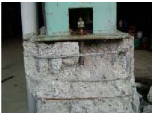
写真-19 S造住宅の被害（長岡市内） （1階露出柱脚アンカーボルトの伸び、柱型せん断破壊） （新潟大学 土井希祐教授撮影）
