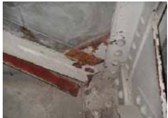
写真-8 堀之内小学校 体育館鉄骨筋違ボルトの破断(東京大学 中埜良昭助教授撮影)
