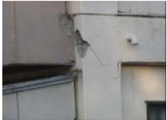
写真-17 RC造戸建て住宅の被害（長岡市内） （1階柱梁接合部のせん断ひび割れ） （新潟工科大学 中野克彦助教授撮影）
