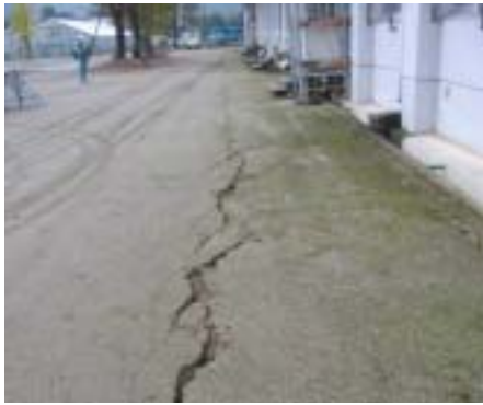
写真-10 宇賀地小学校 校舎棟南側校庭地割れ
