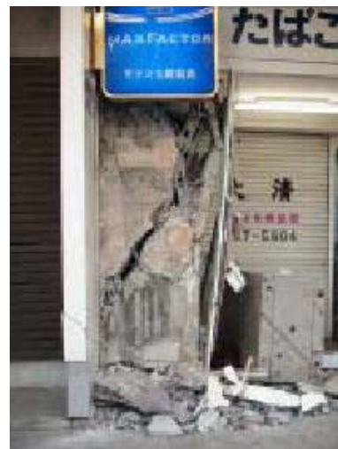
写真-18 RC造商業施設ビルの被害（十日町市内） （1階柱せん断破壊） （福井大学 小林克巳教授、磯雅人講師撮影）
