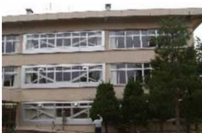
写真-23 耐震補強された RC 造建築物（長岡市内） （新潟大学 加藤大介教授撮影）
