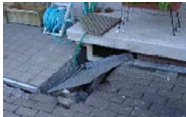
写真-22 同建物 敷地との衝突の痕跡 （新潟大学 加藤大介教授撮影）
