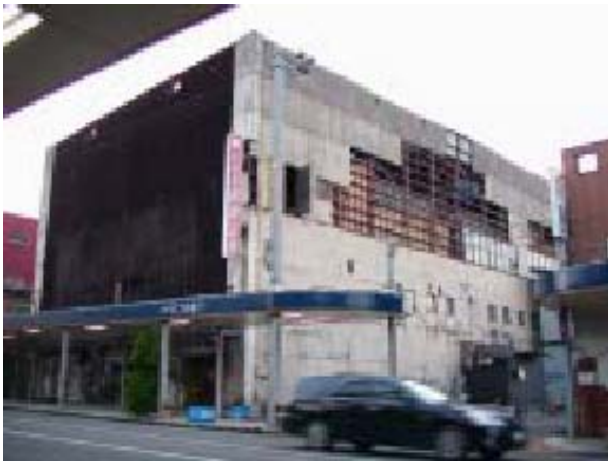
写真-23 非構造外壁の落下（十日町市内） （福井大学 小林克巳教授、磯雅人講師撮影）
