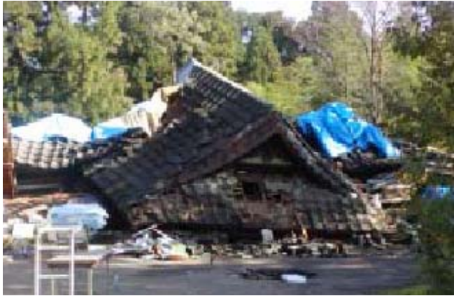
写真-14 木造戸建て住宅の被害（長岡市内） （新潟工科大学 中野克彦助教授撮影）
