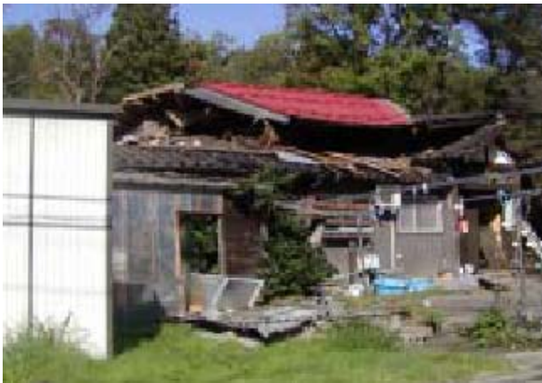
写真-15 木造戸建て住宅の被害（長岡市内） （新潟工科大学 中野克彦助教授撮影）
