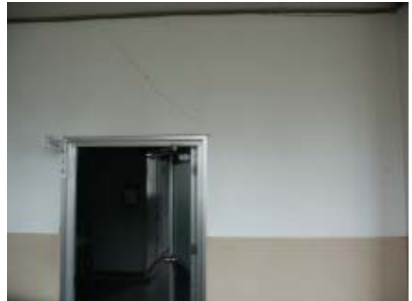
写真-4 大和中学校校舎1階部分便所周囲壁のせん断ひび割れ
