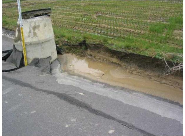
写真 10 滝谷トンネル出口 埋戻し土の液状
