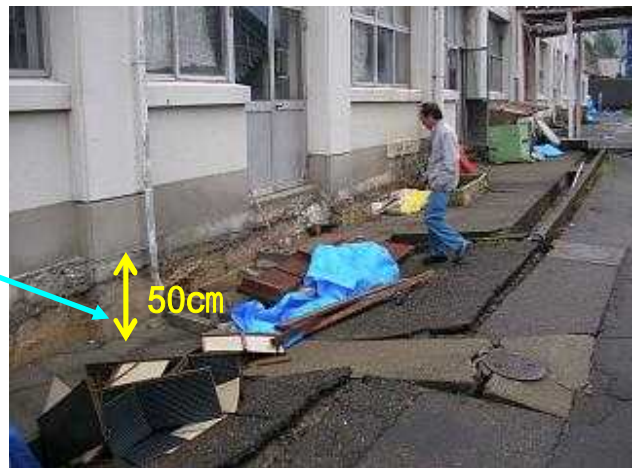
写真 2 3号館背後の沈下
