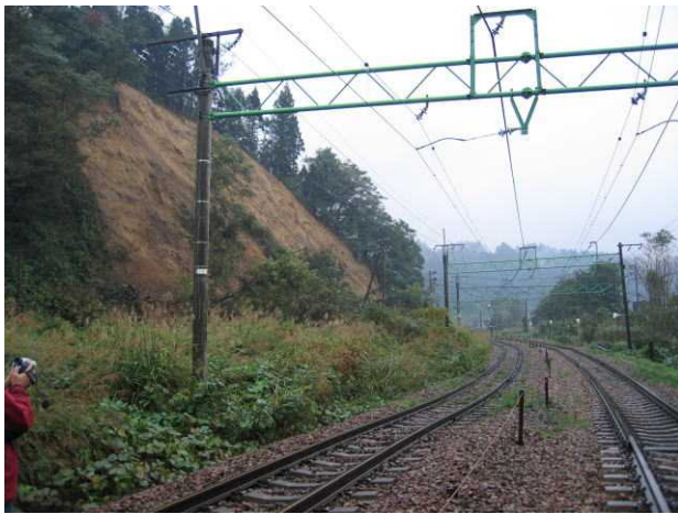
写真-20 斜面崩壊と線路の湾曲 （越後川口駅付近）
