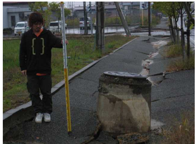
写真-15 マンホールの浮き上がり(小千谷市桜町)
