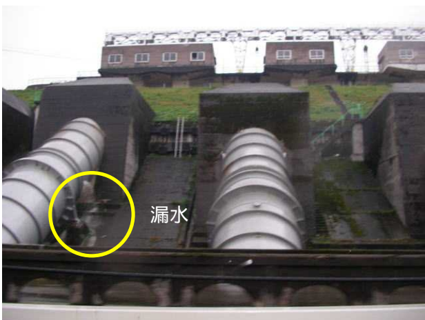
写真 -17 小千谷発電所での漏水
