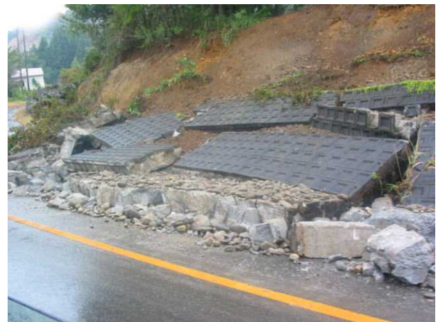
写真 -19 ブロック積み擁壁の崩壊(小千谷市塩殿)
