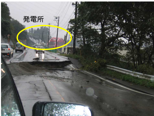
写真 -16 発電所近辺の道路のクラック
