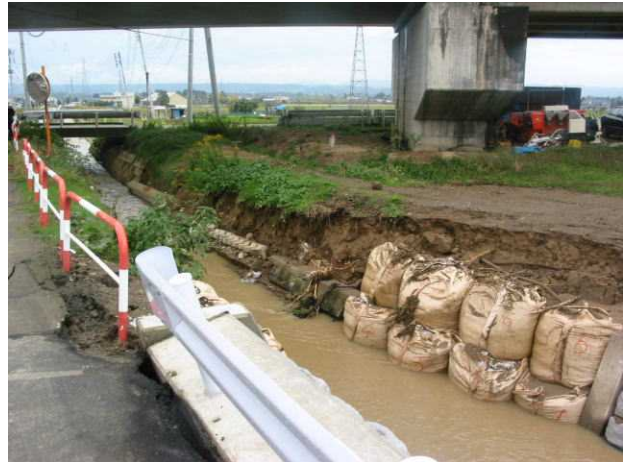
写真 11 滝谷トンネル出口 河川岸壁の崩壊
