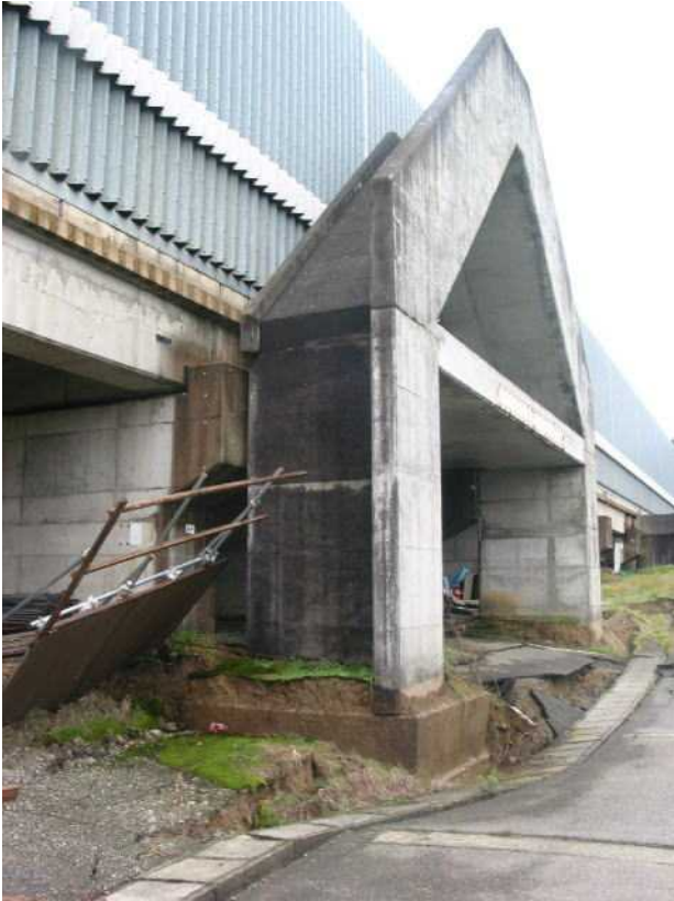
写真 8 滝谷トンネル出口 橋脚周辺地盤の沈下
