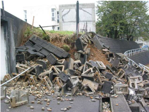
写真 3 崩壊したブロック積み擁壁
