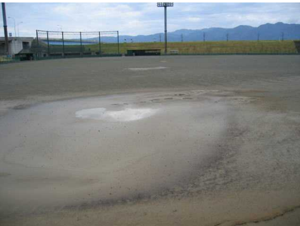
写真-13 越路町河川公園野球場の墳砂跡
